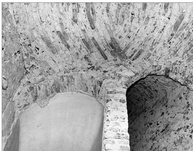
Slika 6: Nedovoljen poseg – uničenje starih ometov (vir: Grobovšek, 2010)
